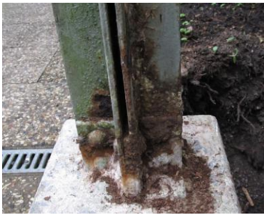
Korrosion am Gewächshauspfeiler
